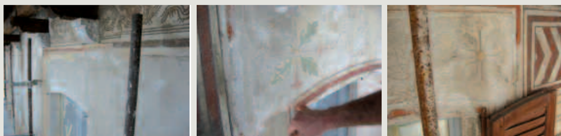
Lacune diffuse nell'intonaco finito a graffito, che impediscono la leggibilità della decorazione
