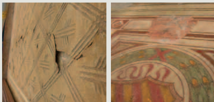
Fenomeni di rigonfiamento e distacchi localizzati nell'intonaco finito a graffito
