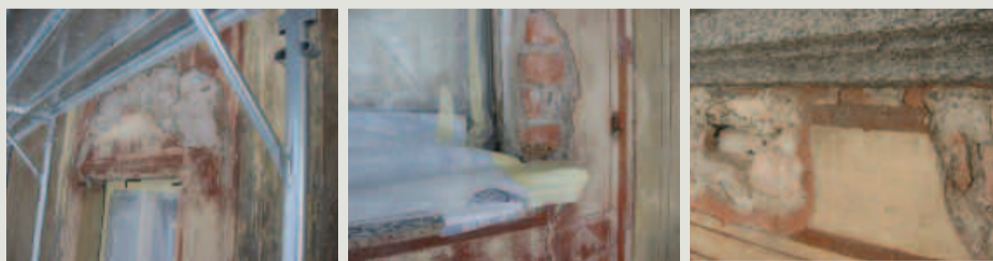
Distacchi localizzati in prossimità delle aperture e delle cornici
