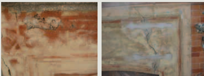
Lesioni presenti nell'edificio. Alcune fessure sono state risarcite e consolidate con cuciture
