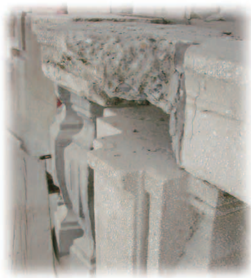
Esempio di fessurazioni e fratture causate dal processo di carbonatazione dei cementi e dall'ossidazione dei ferri di armatura.
